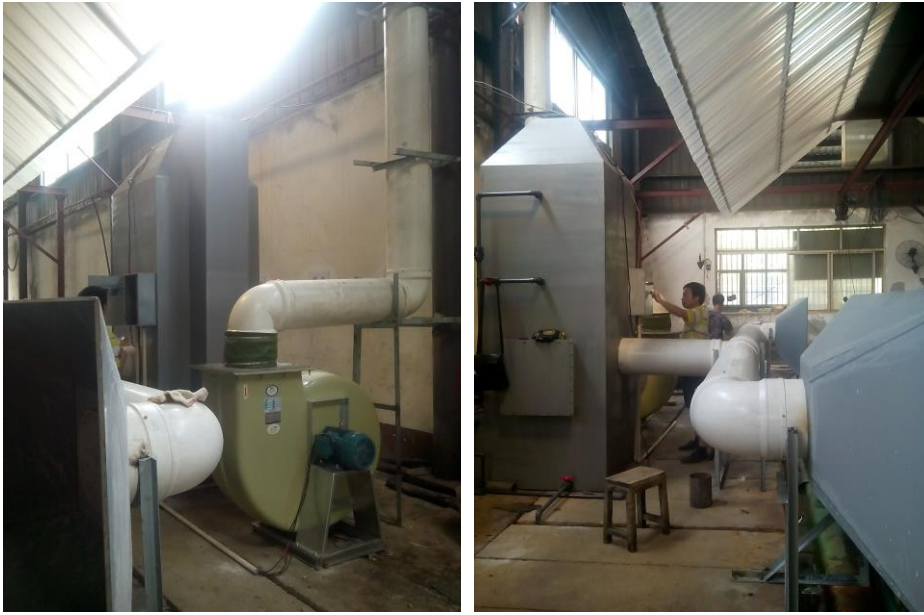
图 9-1 废气处理设施
